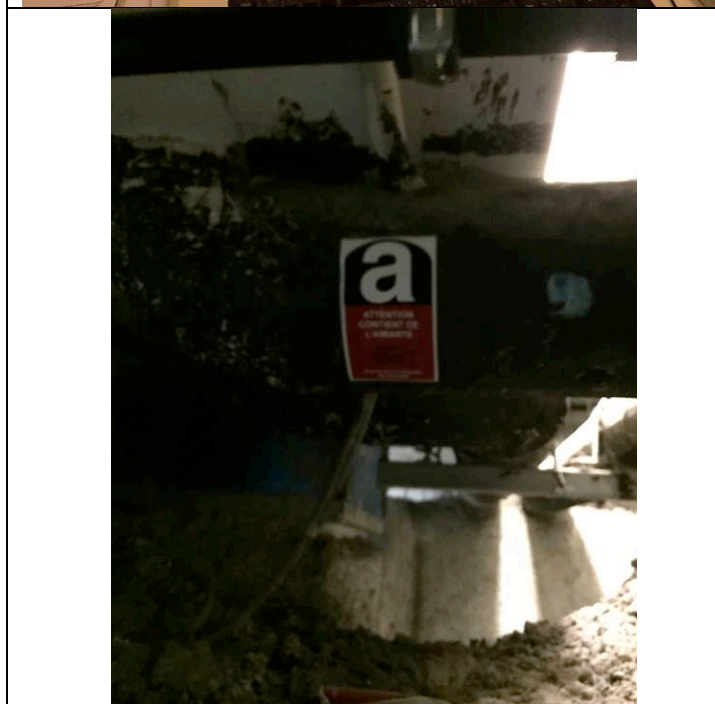
Identification de présence de matériau amianté
